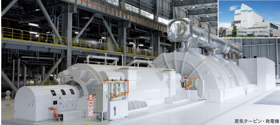
蒸気タービン・発電機
